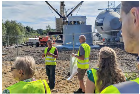
Devant Dimitris - co-responsable du chantier - et un groupe de coopérateurs, la première section du mat de l'éolienne est déjà placée et la tête de la nacelle avec le logo de la coopérative attend patiemment son heure.
