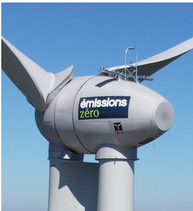
Nacelle de l'éolienne de La Louvière
