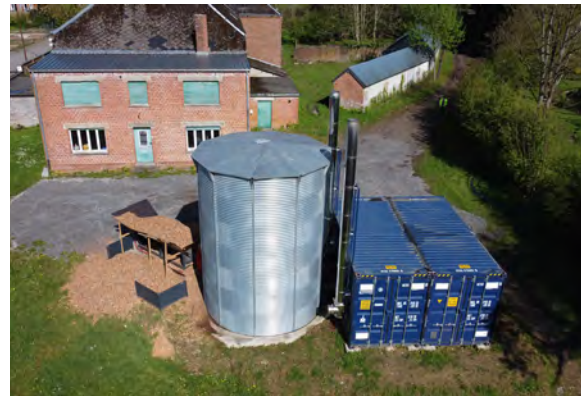
Le silo à bois et les deux containers renfermant la chaufferie bois.
