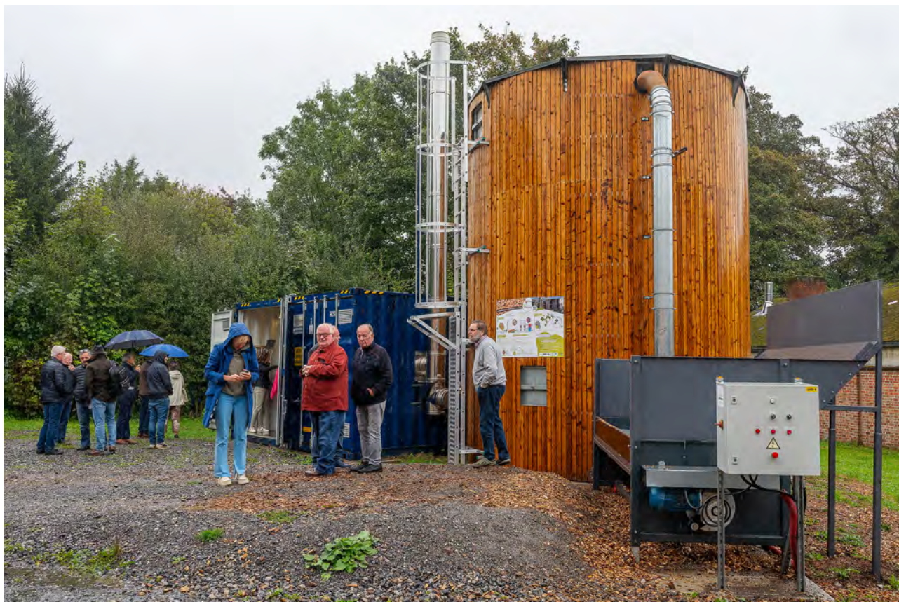
Vue partielle des installations au Domaine des Rièzes et des Sarts (containers des chaudières bois, silo et auge de réception des plaquettes de bois)
